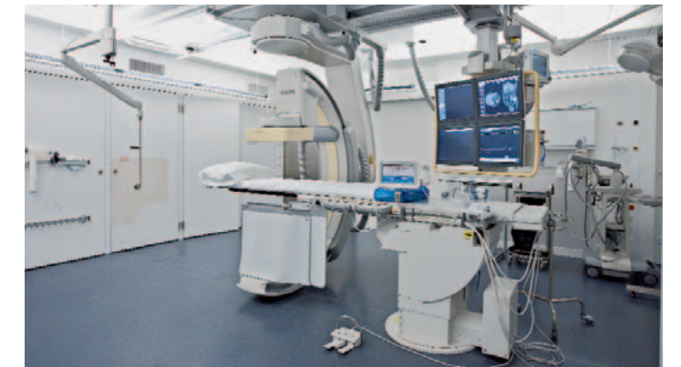
Salle de radiologie interventionnelle équipée du système Philips Allura Xper FD20
