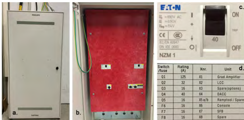
Fig. 233: Exemplos de: (a) uma gMDU fechada, (b) o painel vermelho dentro de uma gMDU, (c) um interruptor DACC e (d) um adesivo da chave de serviço.
