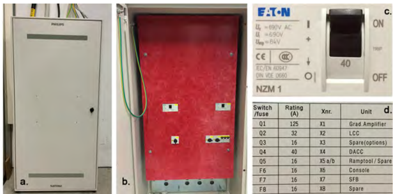
Fig. 9: Exemplos de: (a) uma gMDU fechada, (b) o painel vermelho dentro de uma gMDU, (c) um interruptor DACC e (d) um adesivo da chave de serviço.
